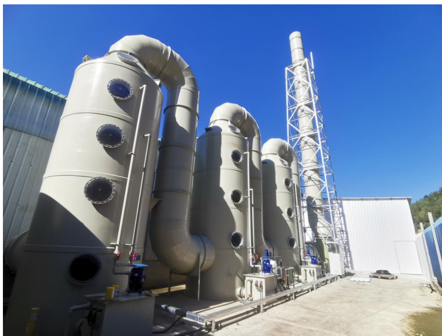
图4-1 水喷淋除臭系统
