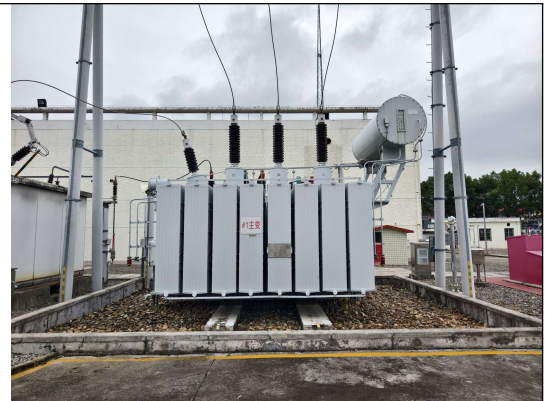
现有 1 号主变（50MVA）
