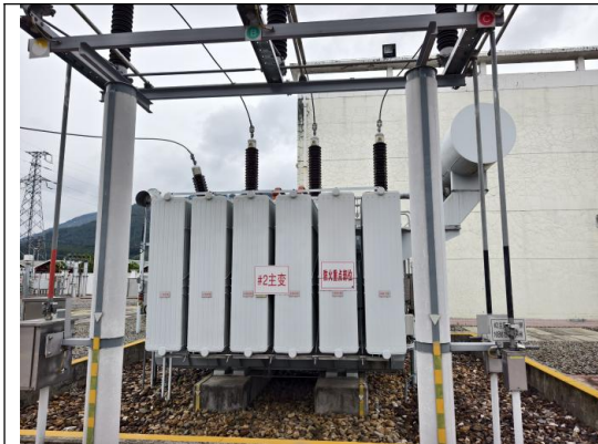
现有 2 号主变（31.5MVA）
