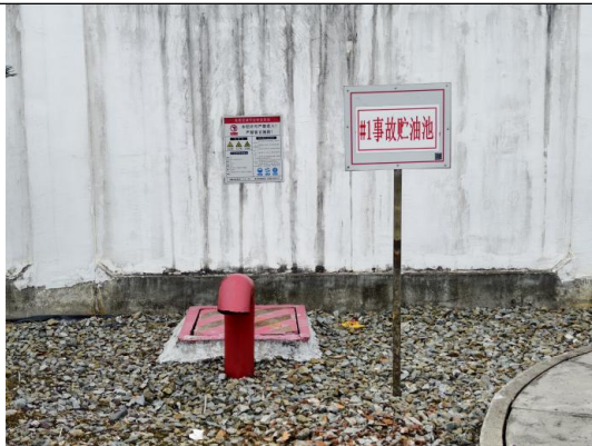
现有#1 事故油池（封堵停用）
