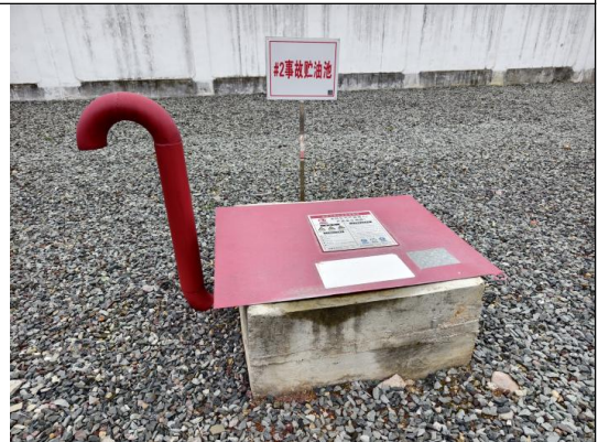
现有#2 事故油池
