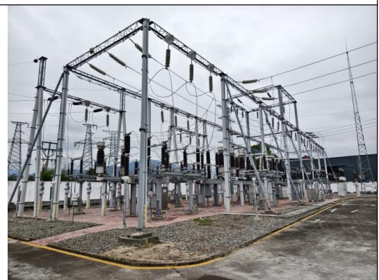
110kV 配电装置室
