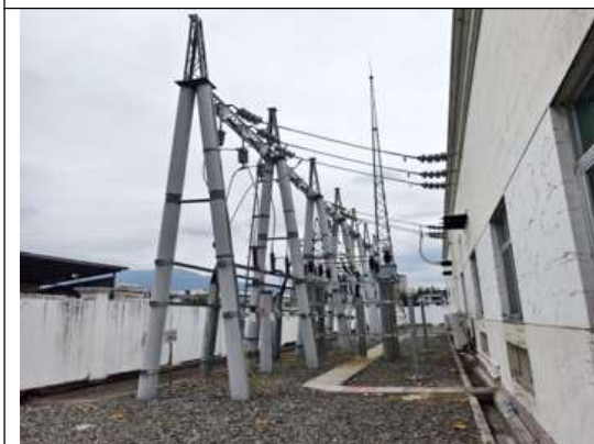
35kV 户外构架
