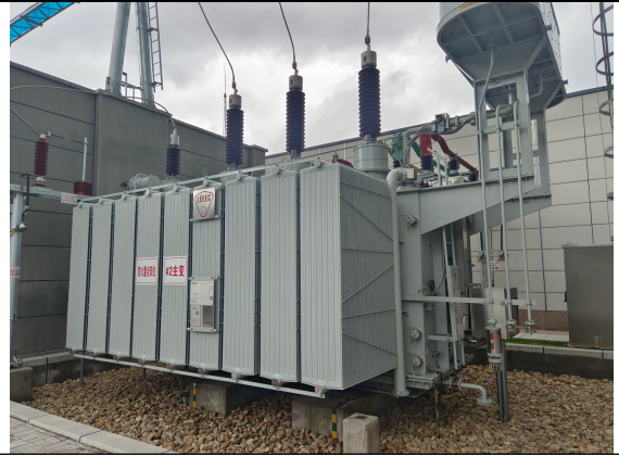
现有#2 主变 (50MVA)
