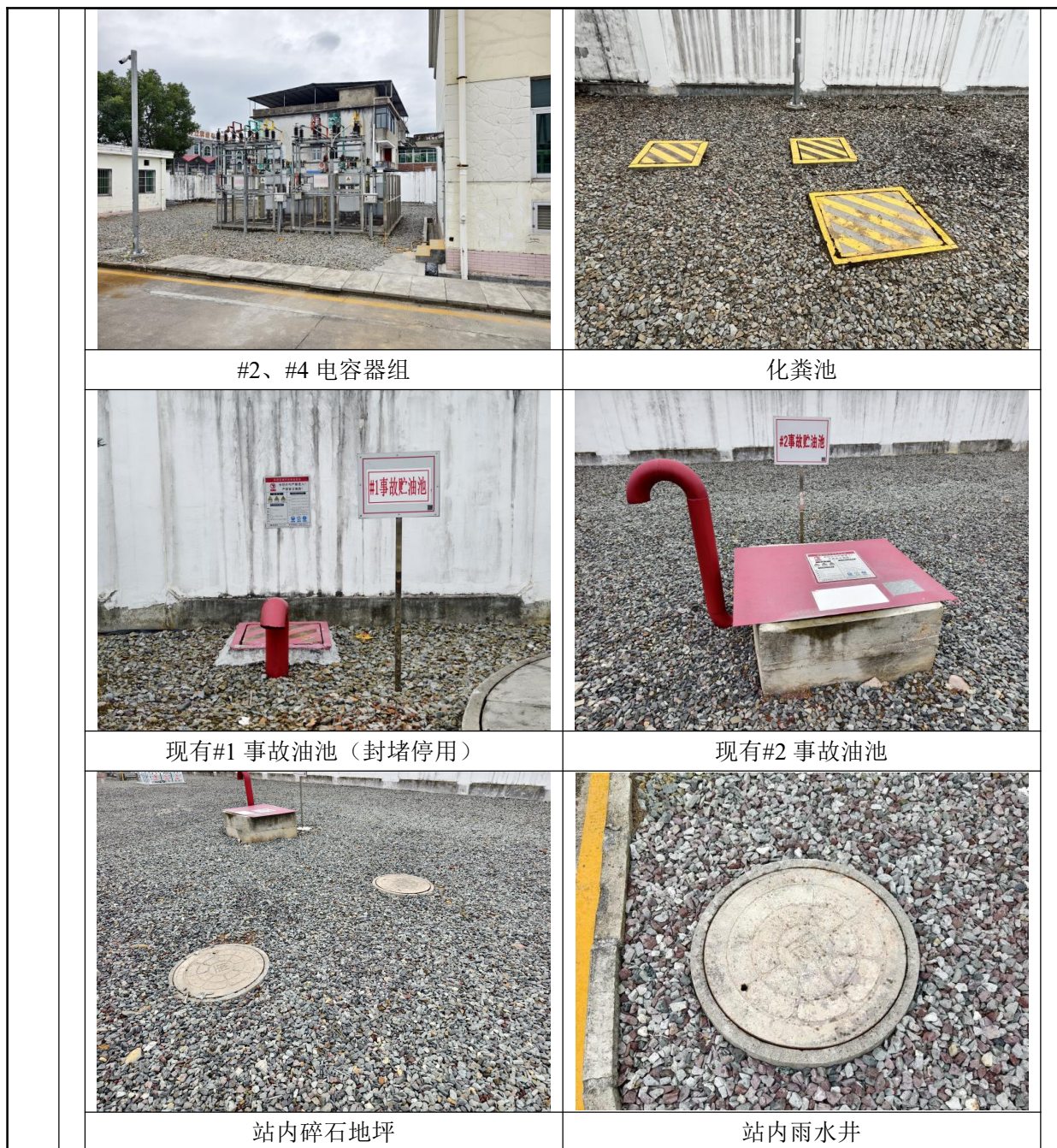
图 2-2 嵩溪 110kV 变电站站内现状照片
