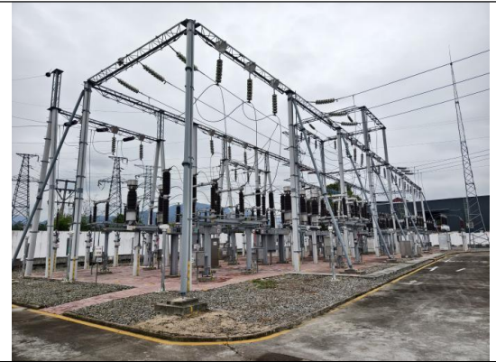
110kV 配电装置室
