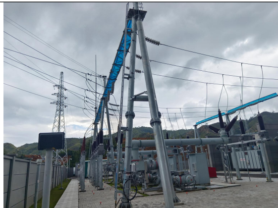
110kV 架空出线
