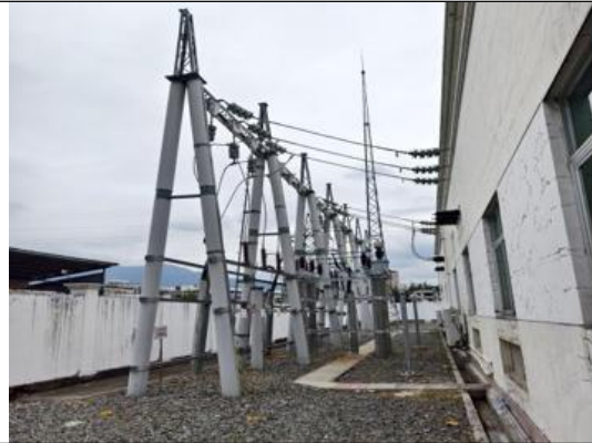
35kV 户外构架
