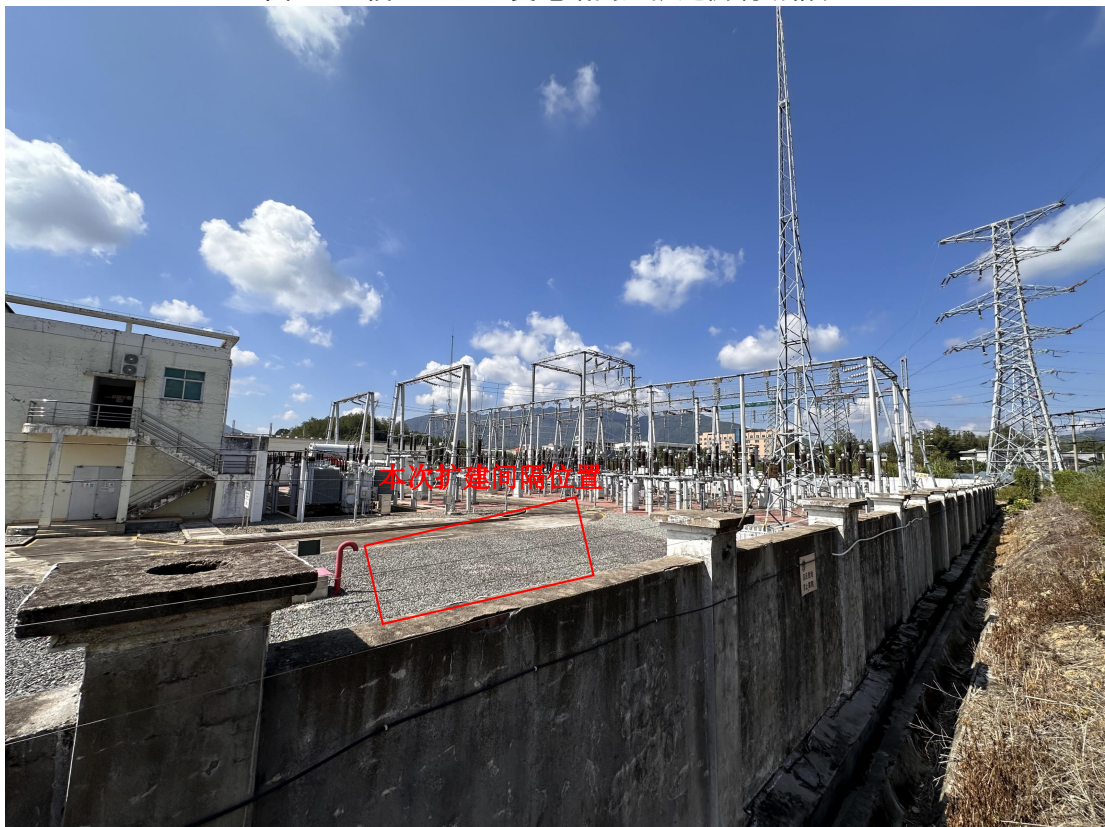
图 2-4 嵩溪 110kV 变电站间隔扩建侧现场情况
