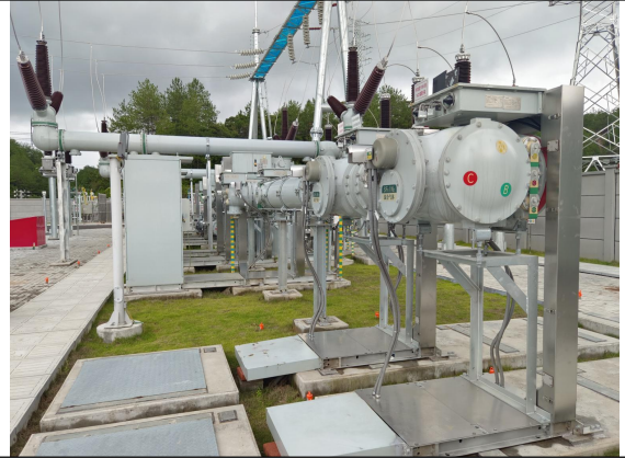
110kV 配电装置
