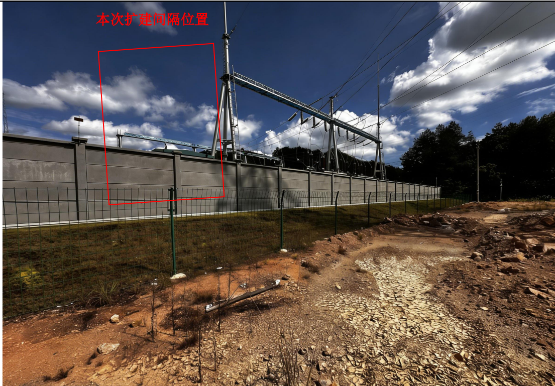
图 2-3 福宝 110kV 变电站间隔扩建侧现场情况
