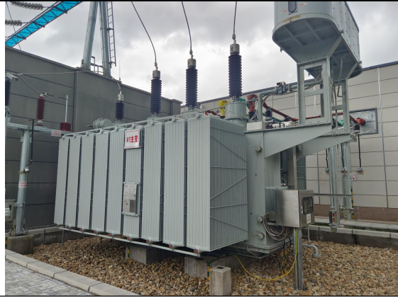
现有#1 主变 (50MVA)
