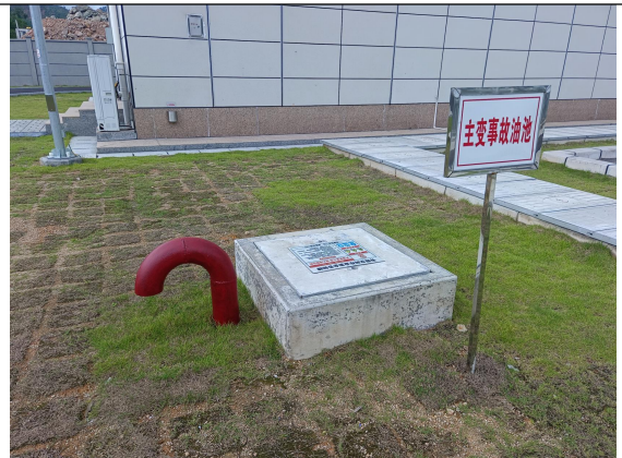
现有事故油池
