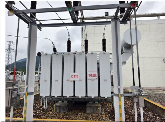
现有 2 号主变 (31.5MVA)
